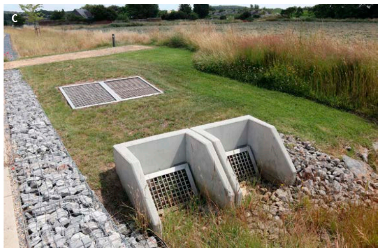
(A) Jardin de pluies (Forêt, Bruxelles). (B et C) Bassins de rétention imposés par la commune de Jodoigne à l'implantation d'un nouveau lotissement.
